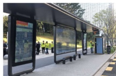
IP对讲 /IP intercom
